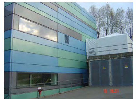
Detail Trafostation mit Geräteschleuse
